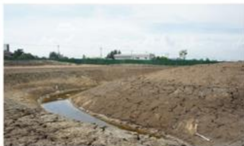
5月 蛇行する小川と、やがて河岸となる川岸を切り開き、形を整えます。
